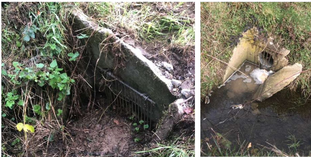
Figure 61 : photo de gauche : drain colmaté à Montacher-Villegardin (10/11/22), photo de droite : drain qui coule, Montacher-Villegardin (16/03/23)
