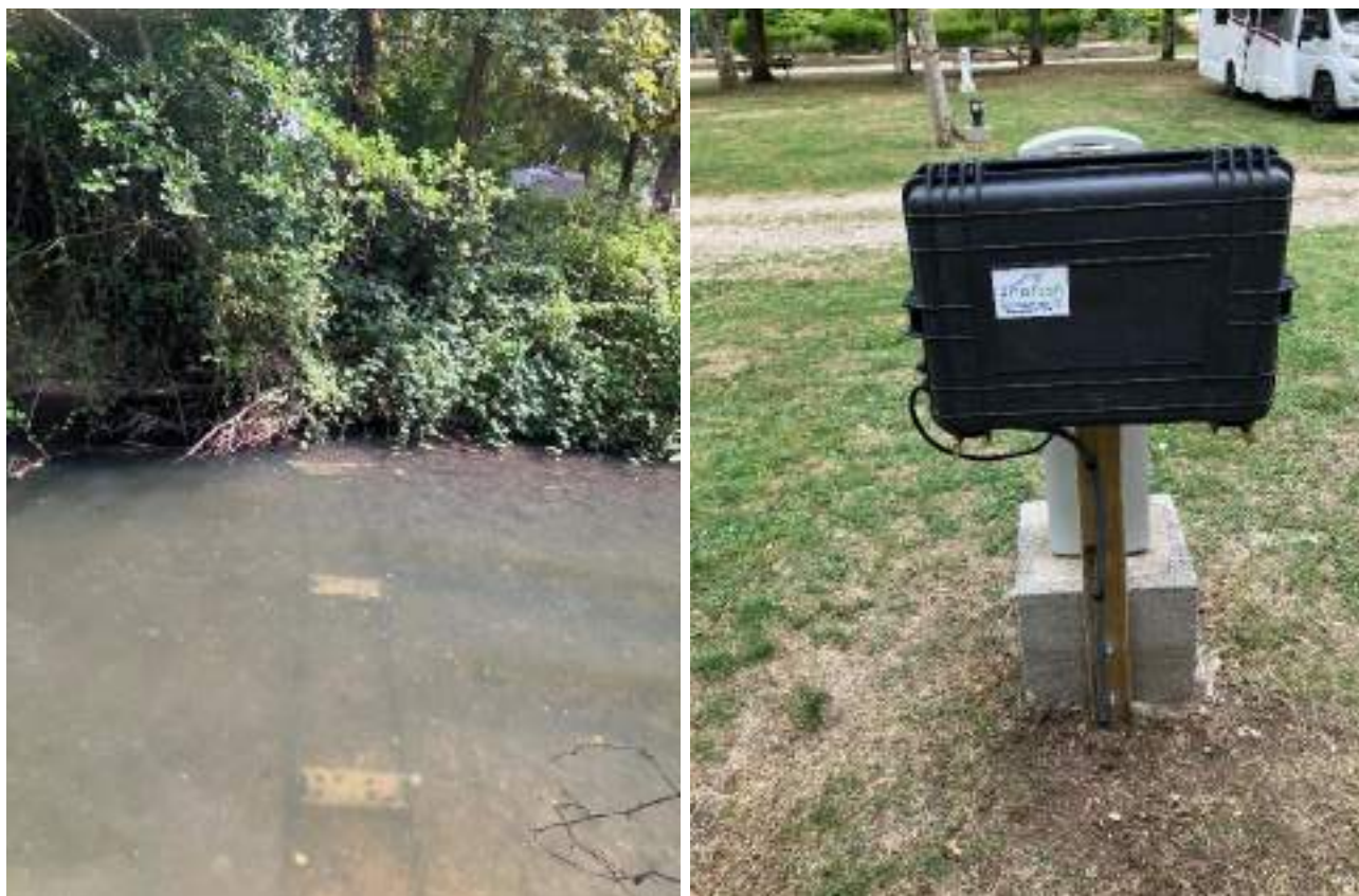
Figure 41 - Installation système de télémétrie - LOING AMONT
