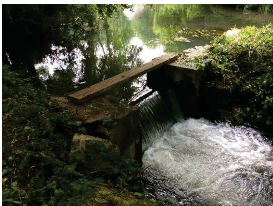
Vue sur le batardeau fermé - Bras de décharge
