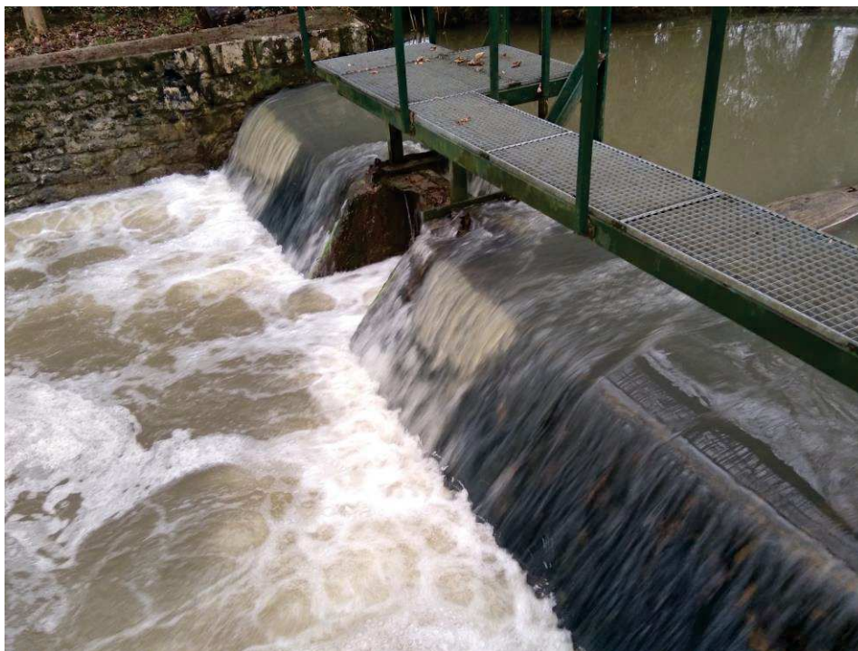
Ouvrage du Perray, équipé d'une passe à poissons
