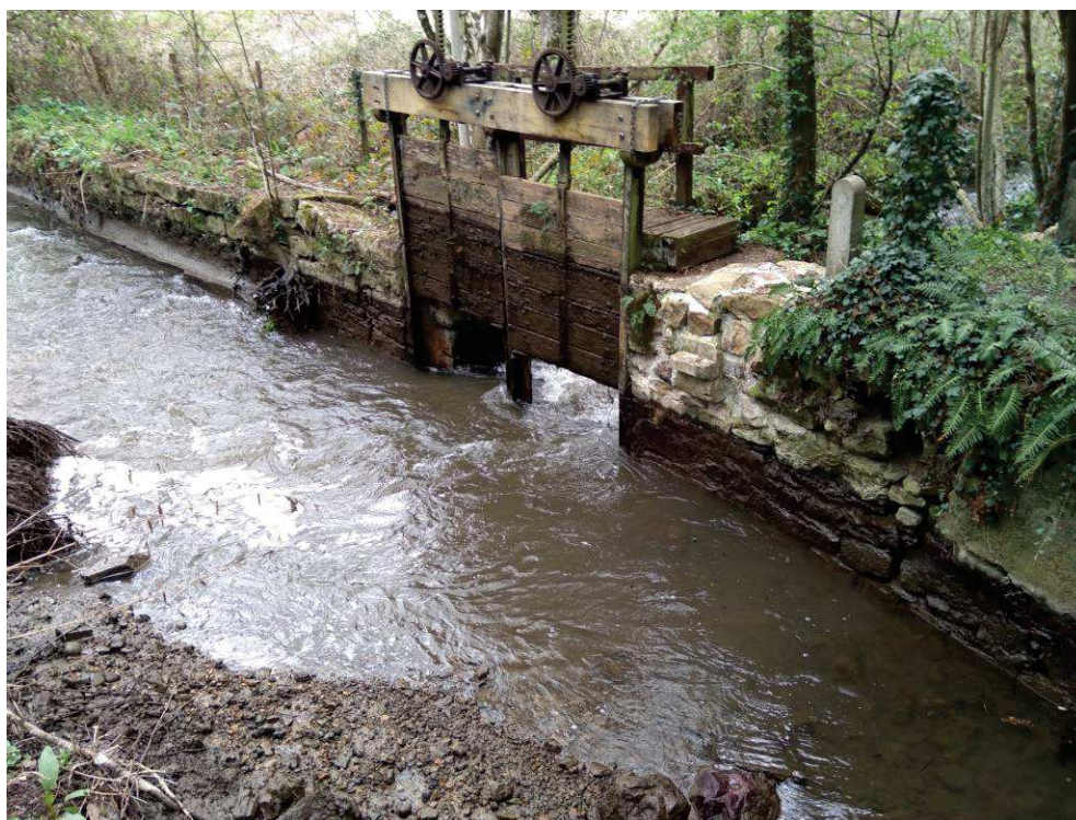
Ouvrage AND2 (vannes ouvertes)
