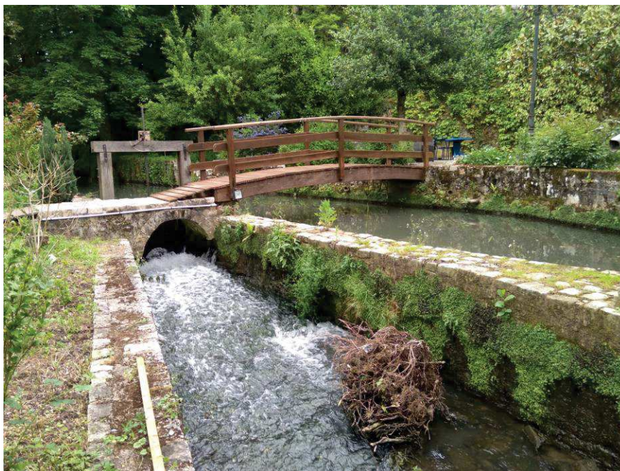
Ouvrage BEZ1 - vanne fermée
