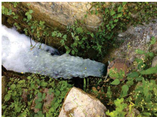
Sortie du bras de décharge (vannes fermées) au droit de PLA1
