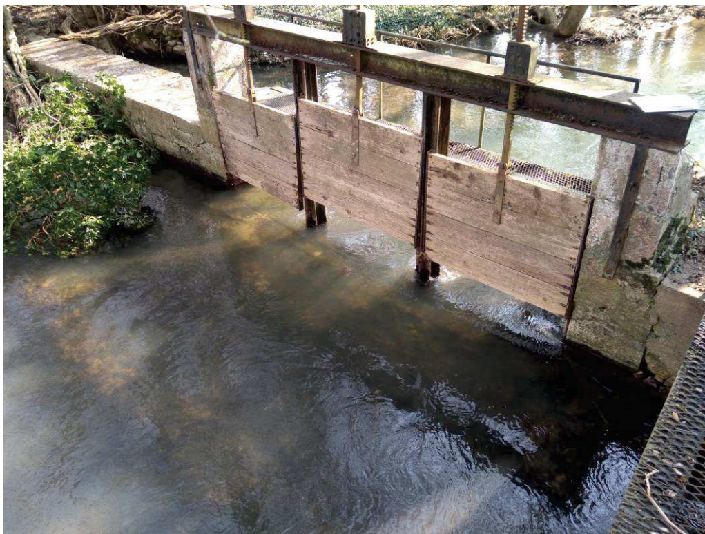
Ouvrage BOY2 - totalement transparent à vannes ouvertes
