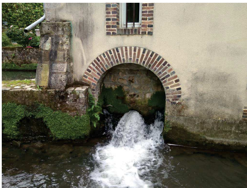
"Fuites" entre le bras usinier et le bras de décharge
