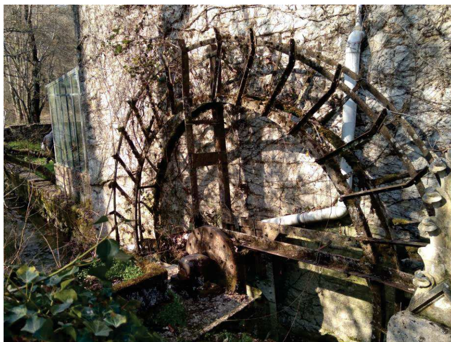
Ouvrage BOY - Roue (dégradée) au droit du bras usinier
