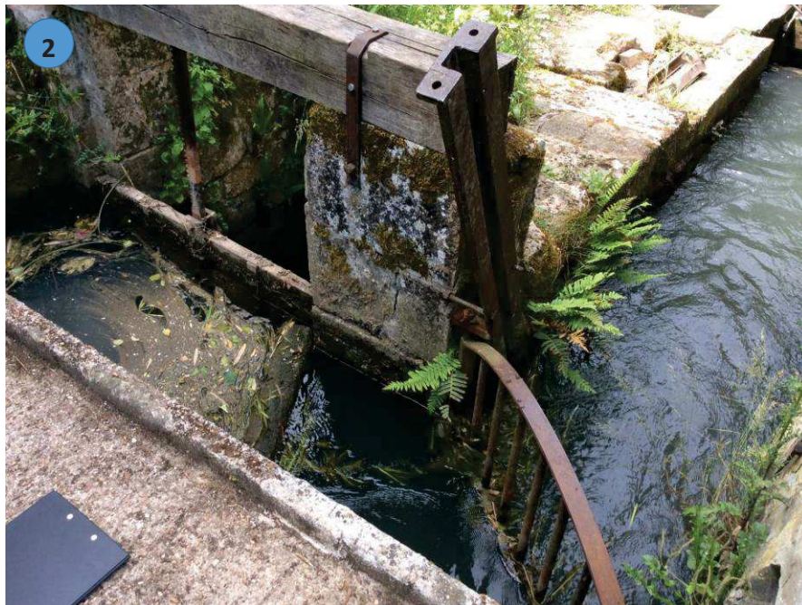
Vanne guillotine de décharge en amont immédiat de la roue
