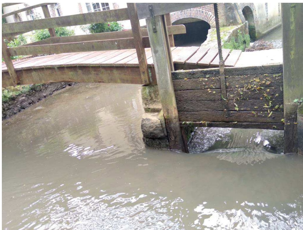
Ouvrage BEZ1 - vanne ouverte
