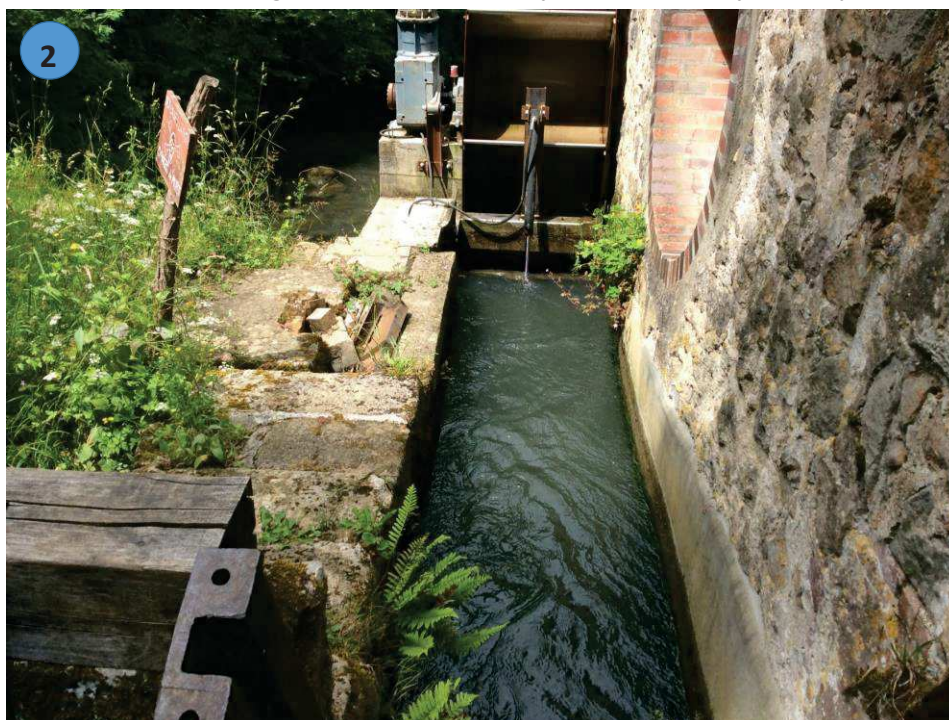
Vanne guillotine usinière (système vérin hydraulique)
