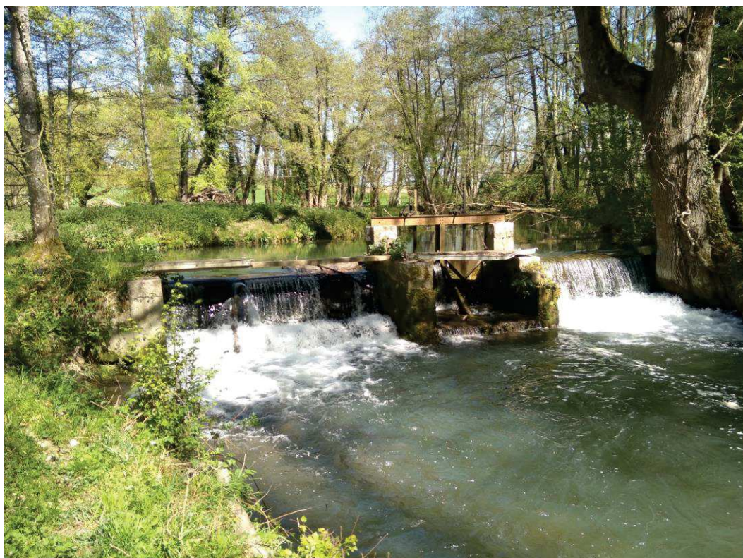
Ouvrage TOS2 - vannes fermées
