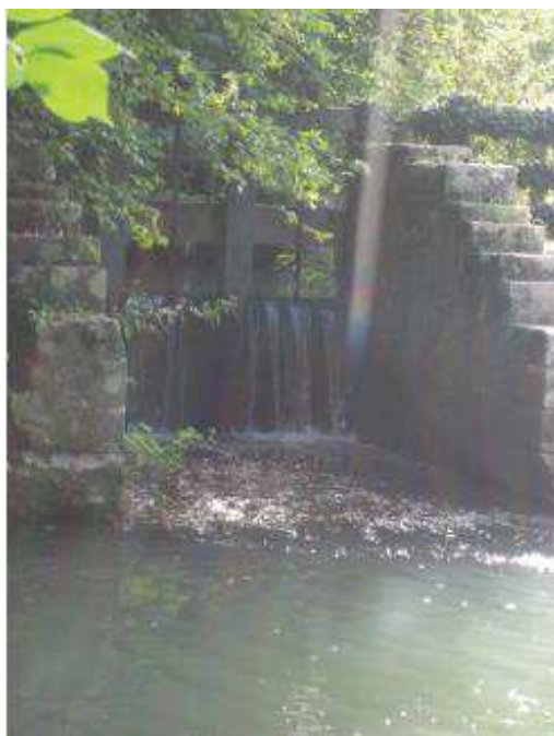
Vue sur les 3 vannes - bras n°1 (source : Géo-Hyd)
