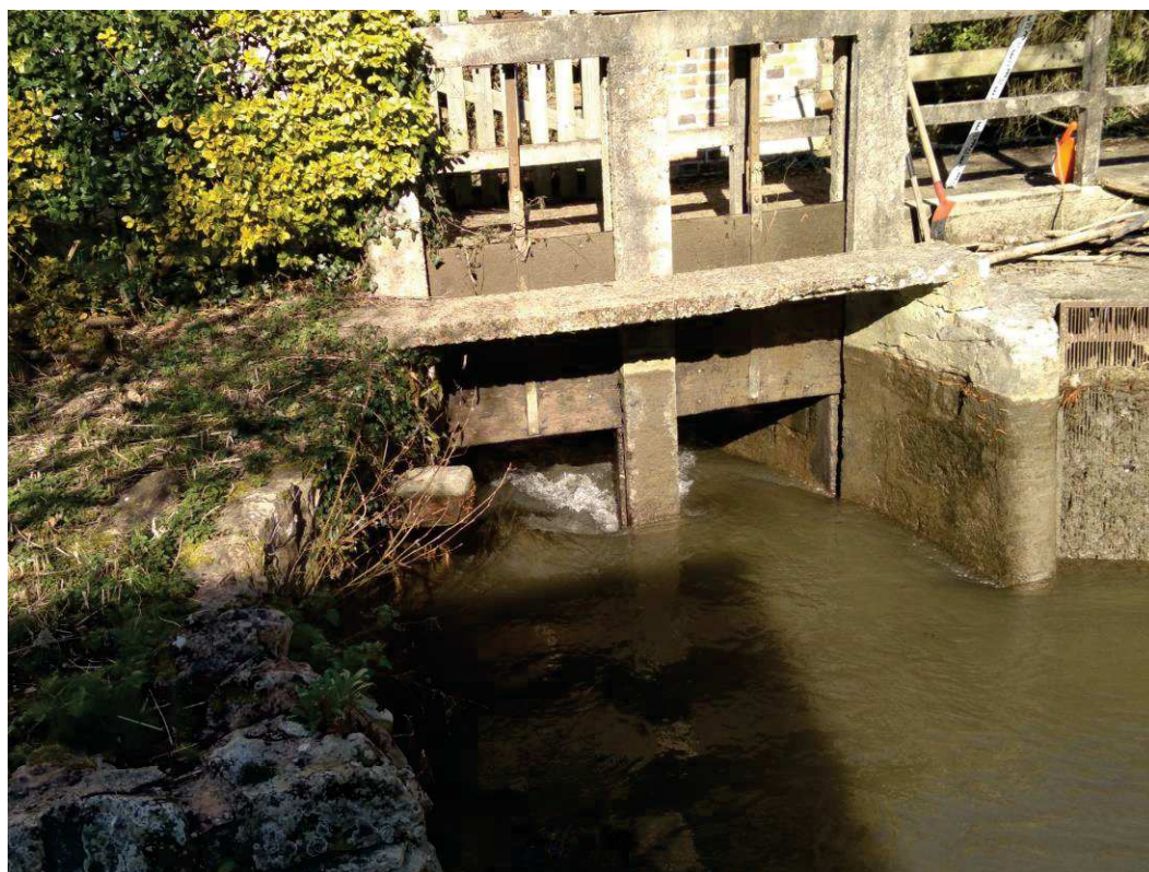
Ouvrage FOU1 - vannes ouvertes
