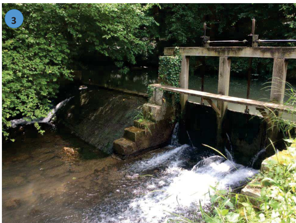
Déversoir avec système de 3 vannes levantes (photo vannes fermées)
